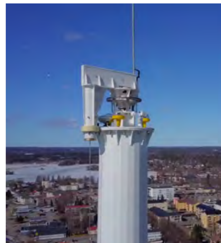
Анемометр, заградительные огни и электрический привод линейного перемещения
